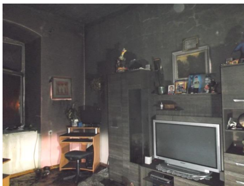
Rys. 2. Widok pokoju po pożarze
