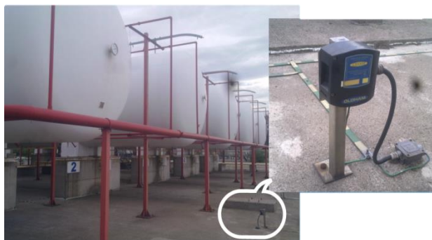
Rys. 2. Zabezpieczenie systemem detekcji gazowej zbiorników z gazem LPG
